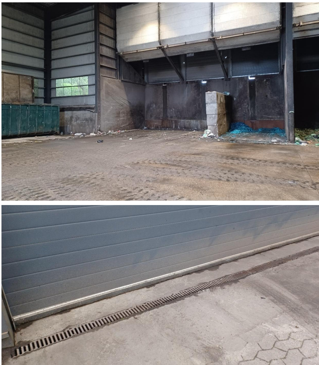
Figur 3. Omlastehal til dagsrenovationslignende affald. Øverst: Område til indsamlet restaffald midt i billedet, til venstre ses container til omlastning, til højre ses grønne poser med madaffald. Nederst: Gummilister til hallen er blevet rottesikret.
