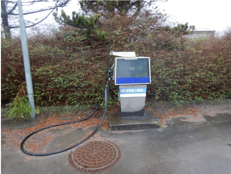
4. Dieseltankanlæg på vaskeplads.
