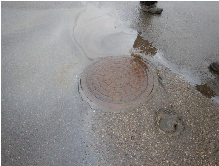
8. Olieudskiller tilknyttet vaskeplads.
