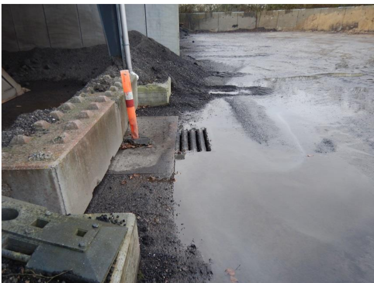
10. Sandfang ved hal til genbrugsasfalt – ikke tømt inden for seneste år.
