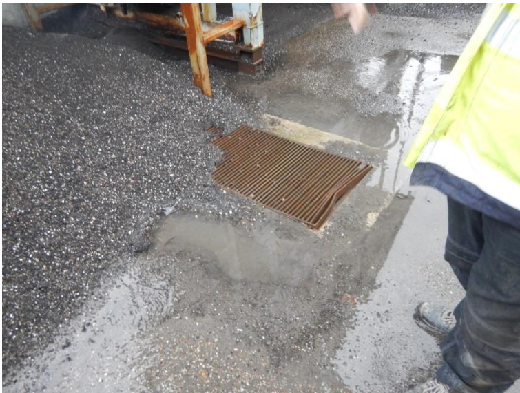
9. Sandfang ved produktionsanlæg.
