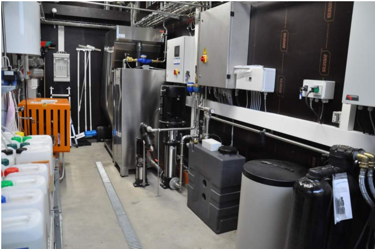
Fig. 2.2 Teknikrum med Bio Classic vandrensningsanlæg
