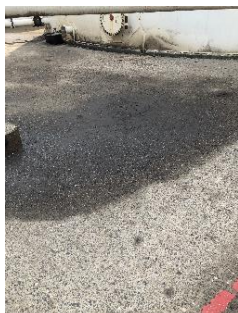
Uidentificeret oliespild i tankgård ved d. fhv. T14, O-vej 9-11
