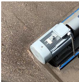
Spild af smøreolie fra pumpe i tankgård O-vej 9-11
