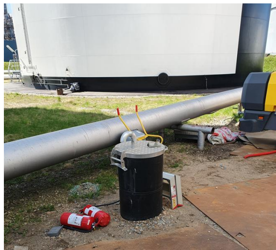
Foto 2: Inspektionsbrønd ved T23
