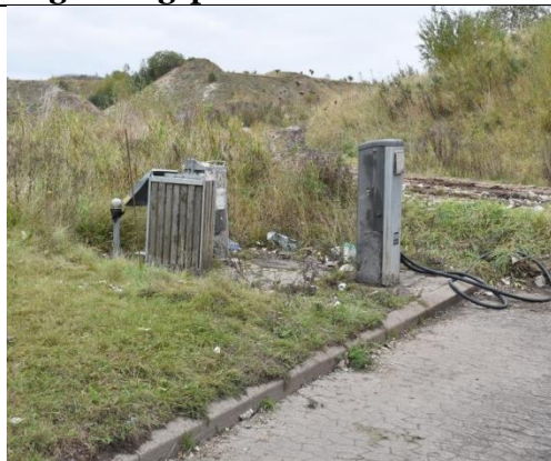
Dieselstander til tankning af materiel. Nedgravet 6000 liter olietank med udluftning.
