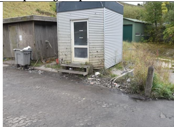
Vaskeplads m/ afløb via olieudskiller i hjørnet ved stolpe. Forurenet vand løber forbi afløbsrist. Belægningen skal udbedres.
