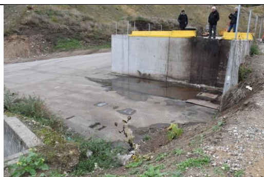
Plads for container har bagfald, så der ikke er afløb til kloakrist i NV-hjørnet.
