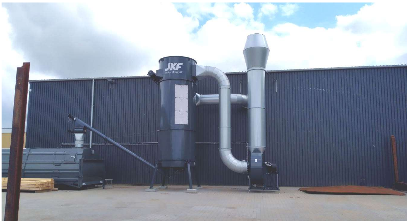
Filteranlæg på nordsiden af hal til behandling af fluff
