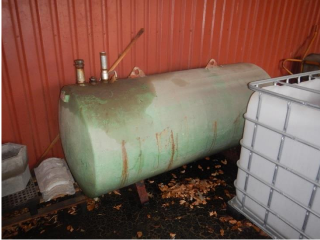
1 . Tankgård med opkant under tag. Fyringsolietank fra 1979- skal sløjfes senest 2019
