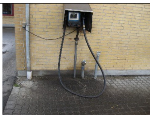
Udleveringsanlæg af diesellole
