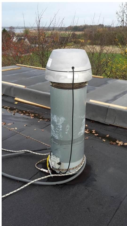
Udsugning bad og omklædning
