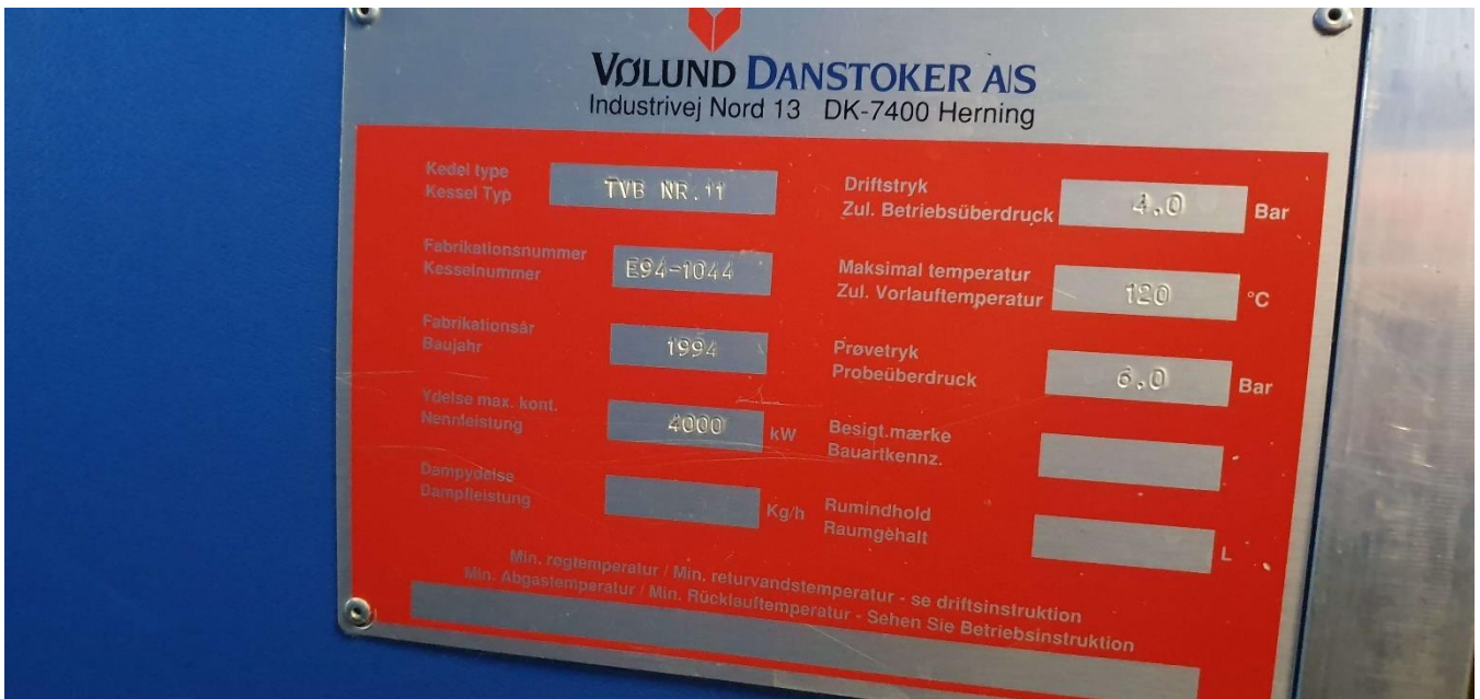
Kedel 1 - 4,0 MW fra 1994.
