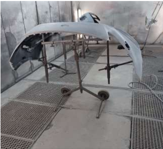
Malekabine – filtre under riste i gulv
