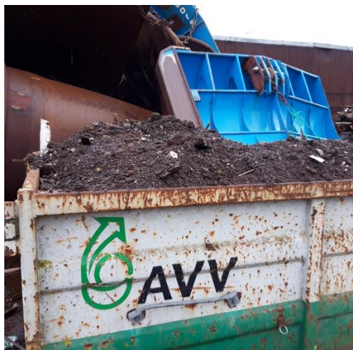
Opfej fra virksomhedens eget areal i forbindelse med oprydning og reovering af belægning. 2/3 af dette materiale vil forventeligt være metaller og frasorteres med magnet inden resten bortskaffes til deponi.
