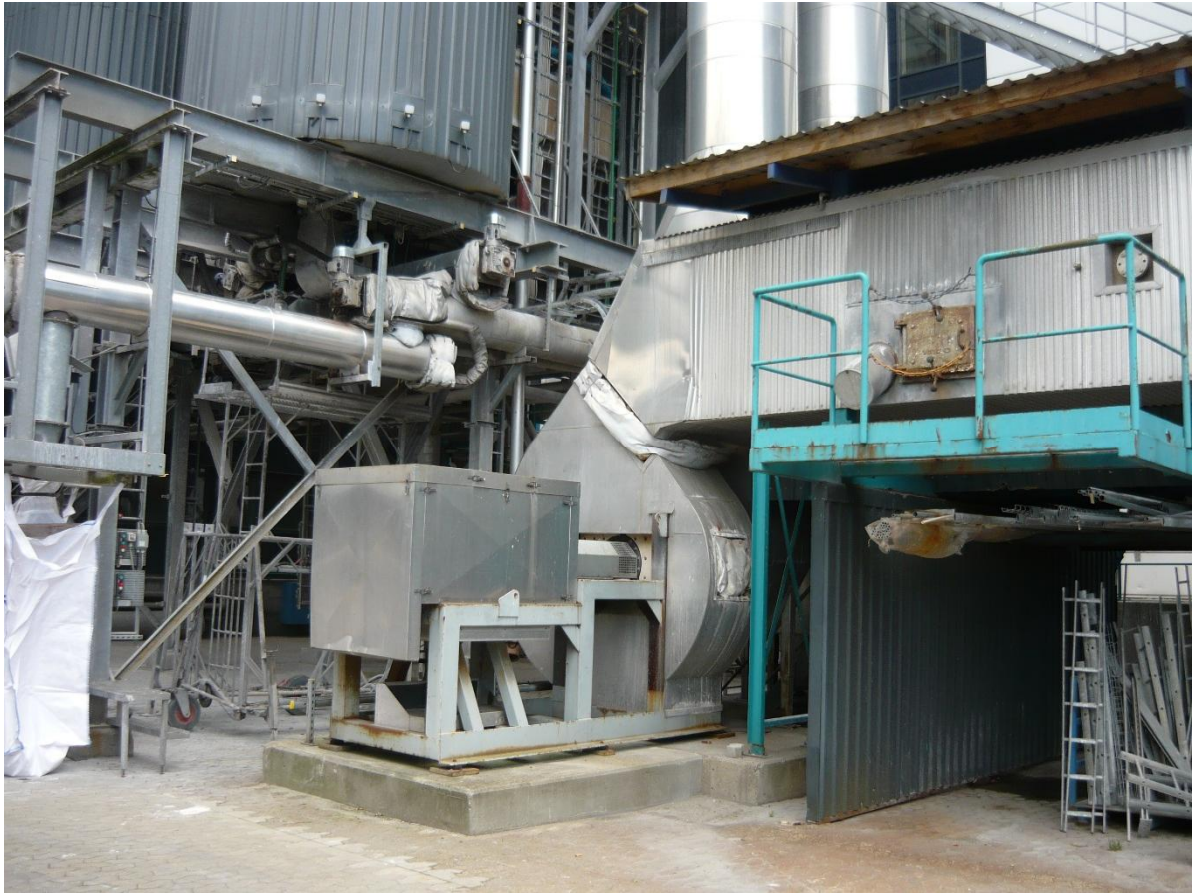
Figur 2: Eksisterende sugetræksblæser i gården. Blæseren bliver udskiftet i forbindelse med ombygningen.
