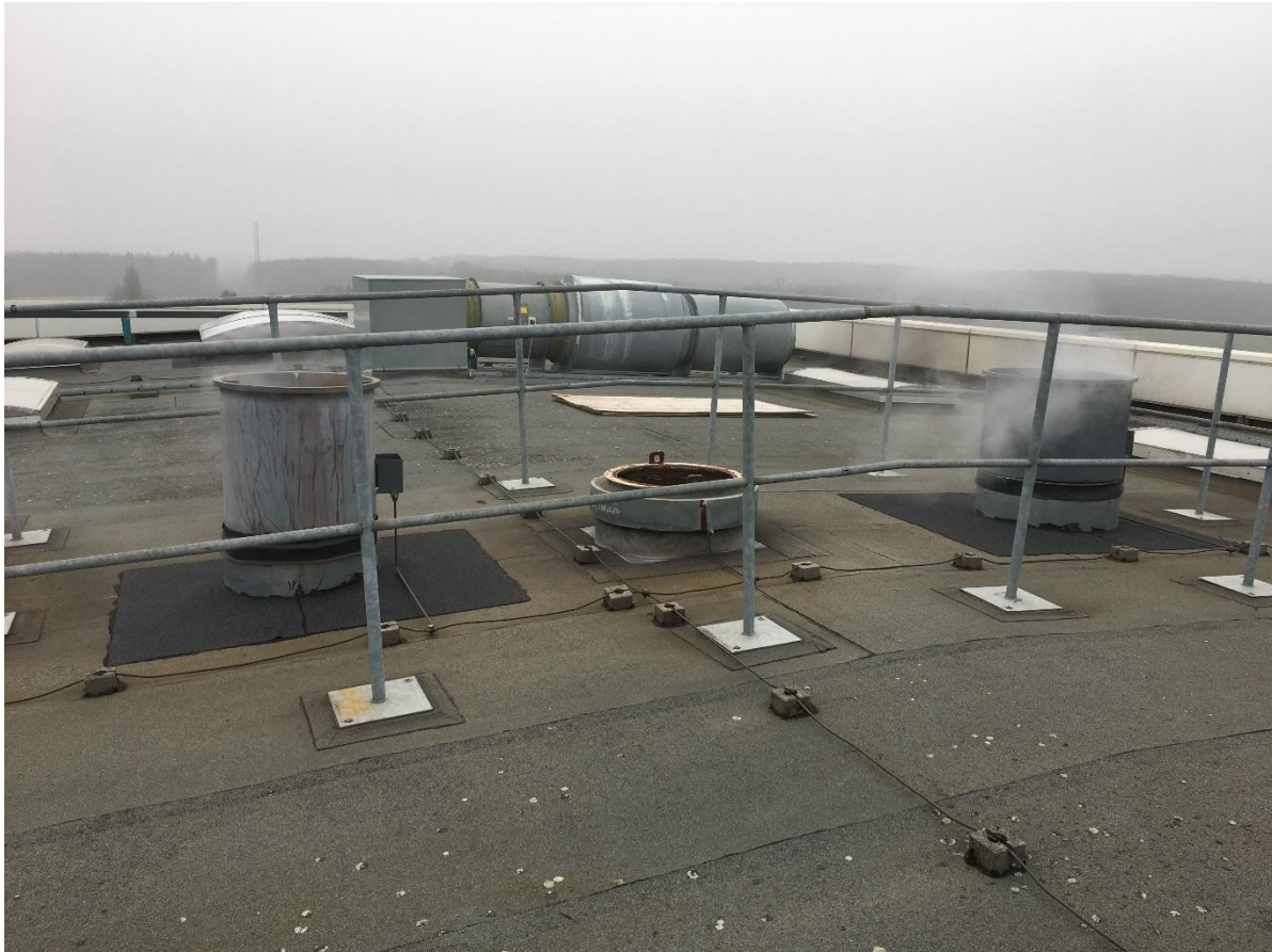
Figur 29: Afbłæsning fra opstartsventil over tag (midterste afblæsning)
