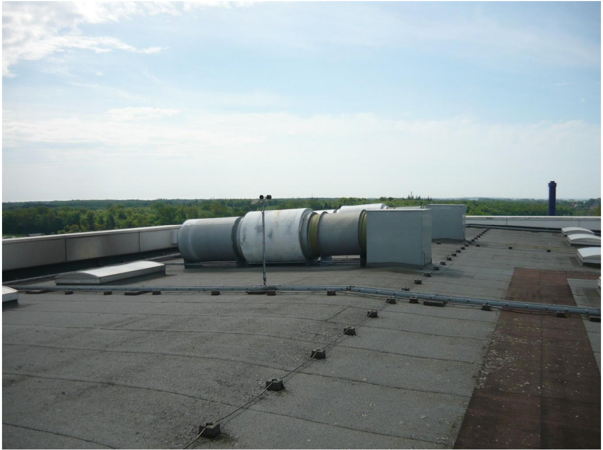
Figur 7: Udsugninger på tag af ovnhall 3. Der findes i alt 4 udsugninger på tagfladen.
