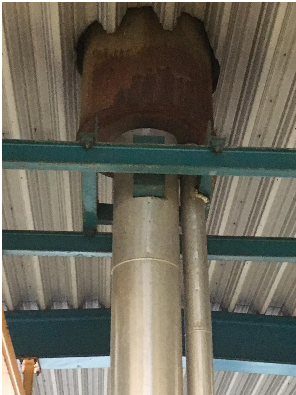
Figur 26: Afkastkanal fra opstartsventil med lyddæmper placeret under tag.
