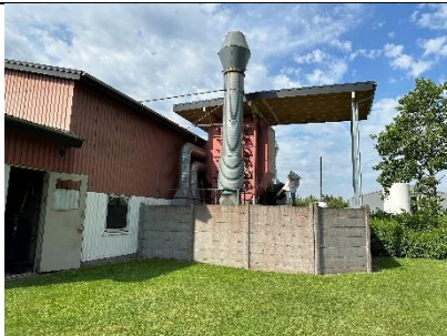
Billede nr. 1: Eksisterende udsugningsanlæg
