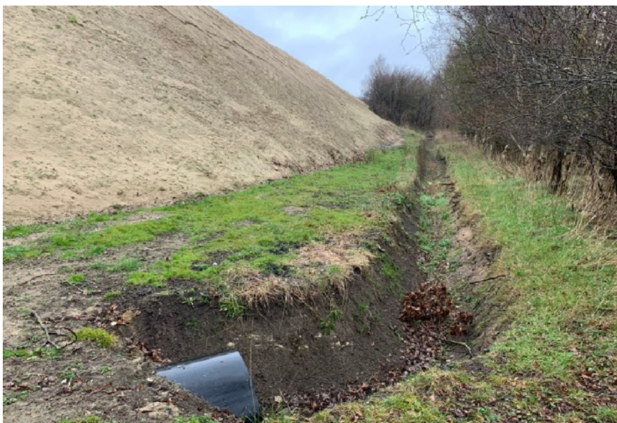
Foto af drænkanal ved støjvold.
