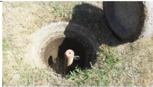
PB1 – monitoringsboring med vandtæt lukning og lås og lav beskyttelsesbrønd.
