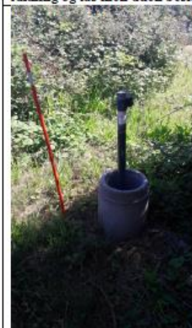
B1 - med vandtæt lukning og lås på det høje rør og lav beskyttelsesbrønd.
