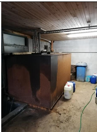
Buffertank til udledning
