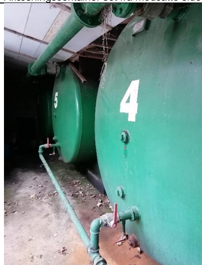
6 stk settlingstanke, indløb foroven, afløb nederst.
