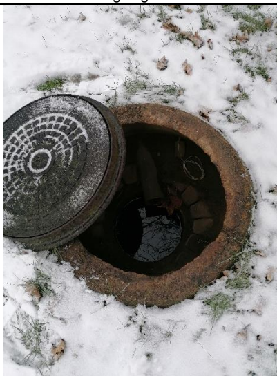
Brønd syd for anlægget, hvor der udtages spildevandsprøver.
