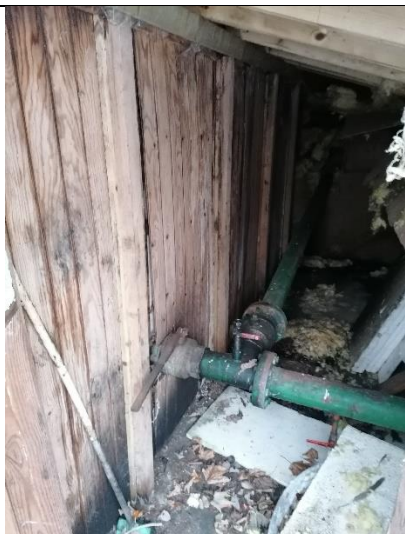
Afløb fra aflæsningscontainer til settlingstanke.
