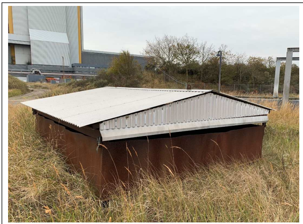
Stort overdækket brandslukningskar
