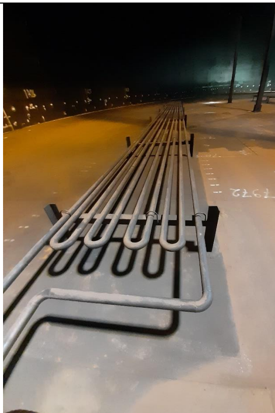
Varmerør i M11
