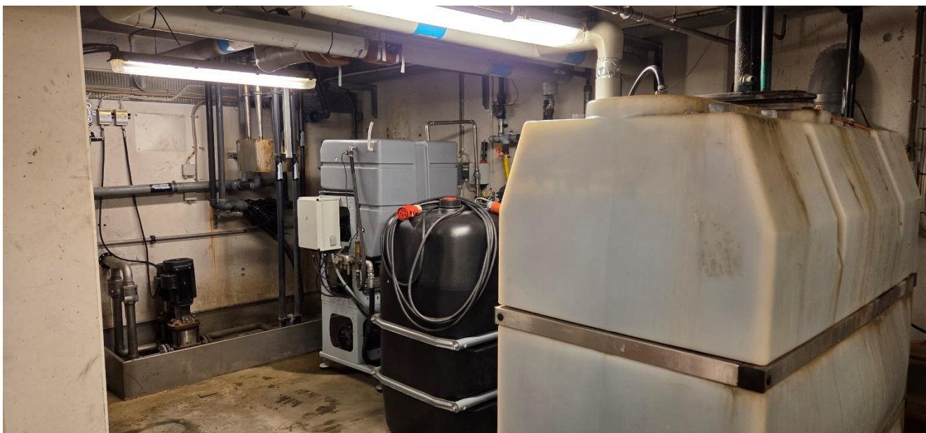
Renseanlæg for spildevand fra vaskehal med hydrocyklon og vandtanke.
