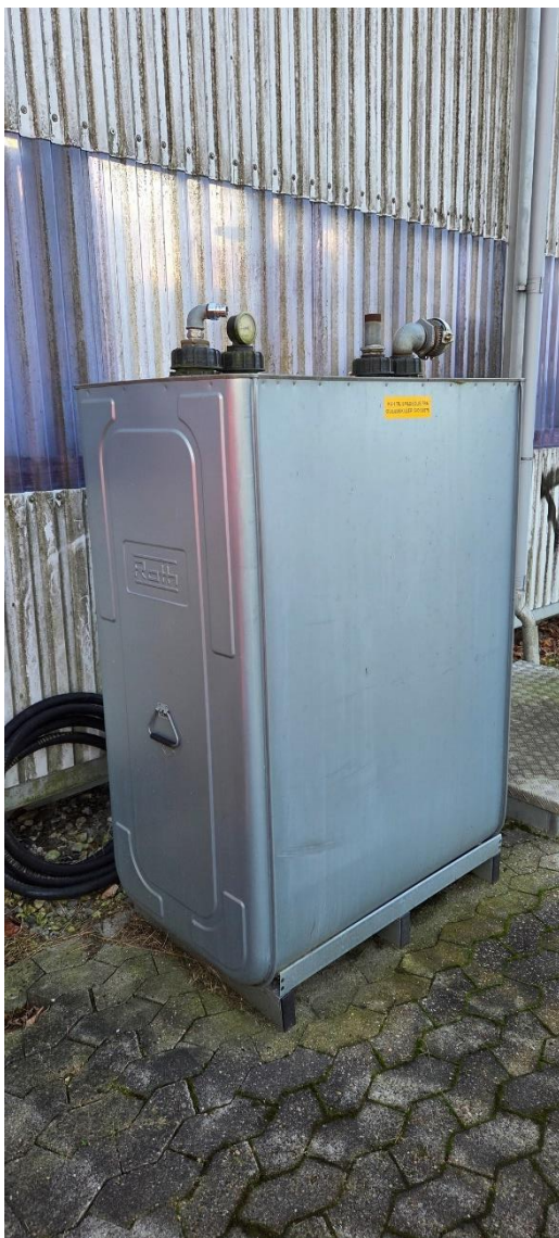
Olietank til overpumpning af olie fra olieudskiller.
