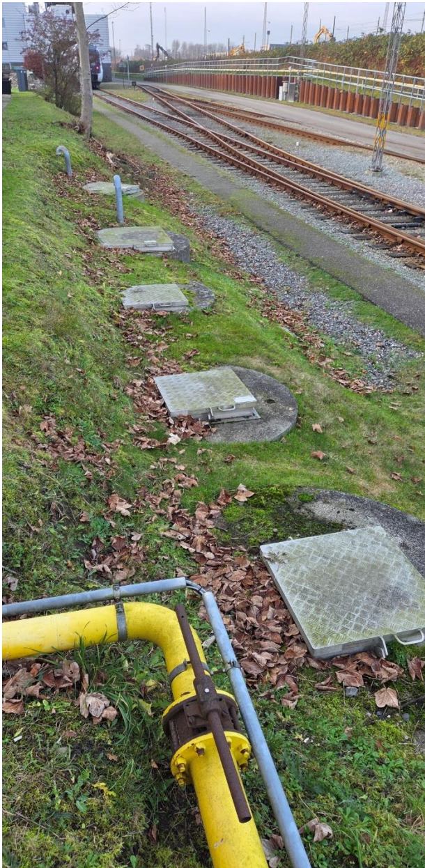
Spildevandsbrønde ved klargøring. Fra nærmest til længst væk ses følgende: Sandfangsbrønd, olieudskiller, prøvetagningsbrønd, drænvand/overfladevand, spildevandsbrønd.
