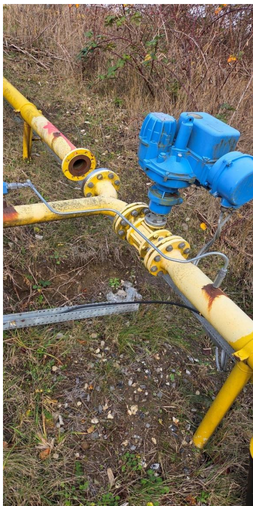
Rørføring fra tankanlægget og frem til Sonnesgade 21 benyttes ikke længere og er derfor frakoblet og rengjort.
