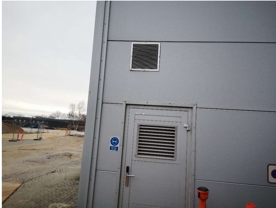
KC03 Indsugningsriste N. Målt 29/1-24
