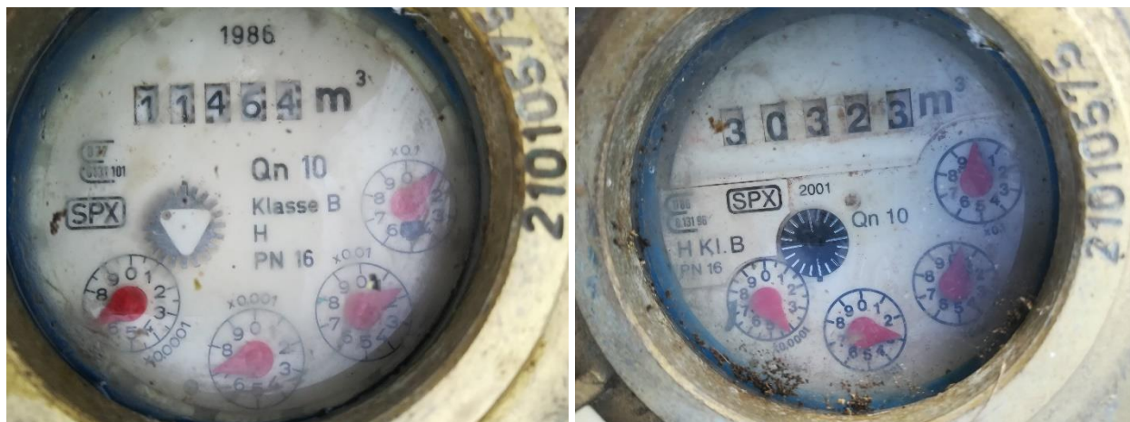
Billede 3 Måleren på perkolatpumpen tv. billede fra tilsynet 21. januar 2021 th. billede fra tilsyn 23. februar 2022
