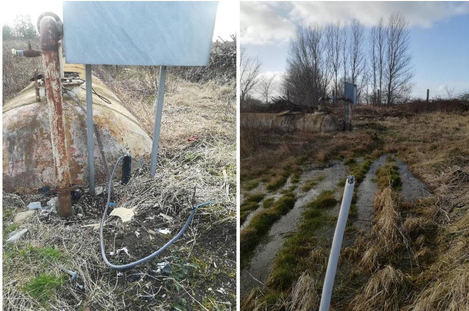
Billede 2 Overklippede kabler og smadret bund ind til el-tavlen
