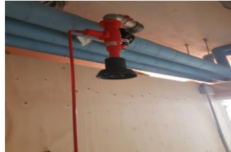
Ny. Nødbruiser ved chlor rum.
