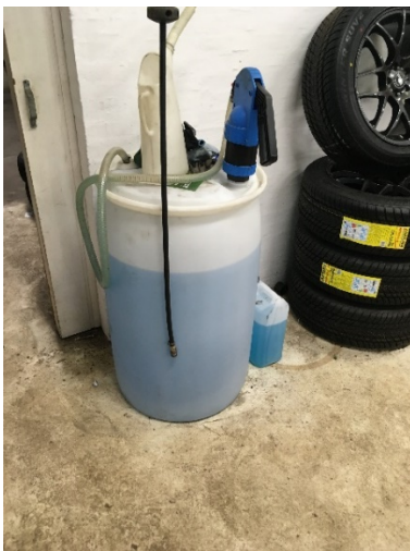
Oplag af sprinklervæske uden spildsikring og tæt på port med mulighed for spild til omgivelserne.
