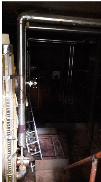
Pumper og tanke er fjernet ved tidligere resin produktion
