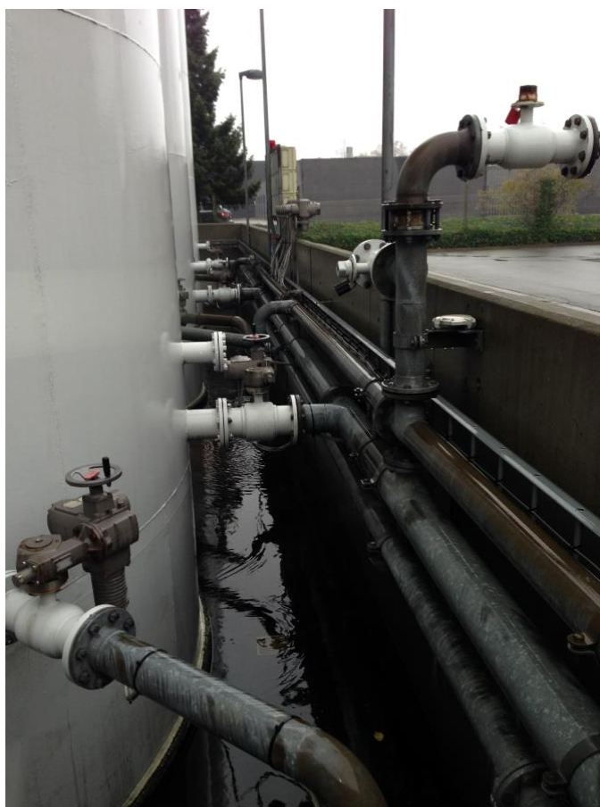
Tankgård med manuel aftapning af regnvand.
