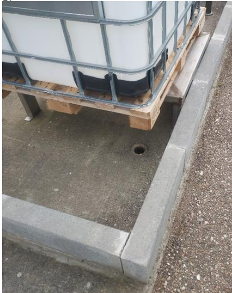
Foto 3: Utæt opkant til tank D-3308.
