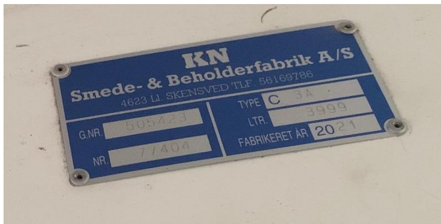
Tank i Hallen v/kontor: Tankmærkat 3999 I, fabrikeret 2021
