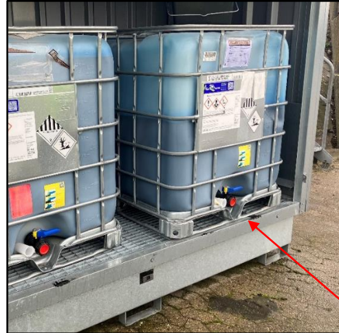
AdBlue i container med opsamling, Kuwaitvej – studsen på tanken til højre er udenfor opsamlingen
