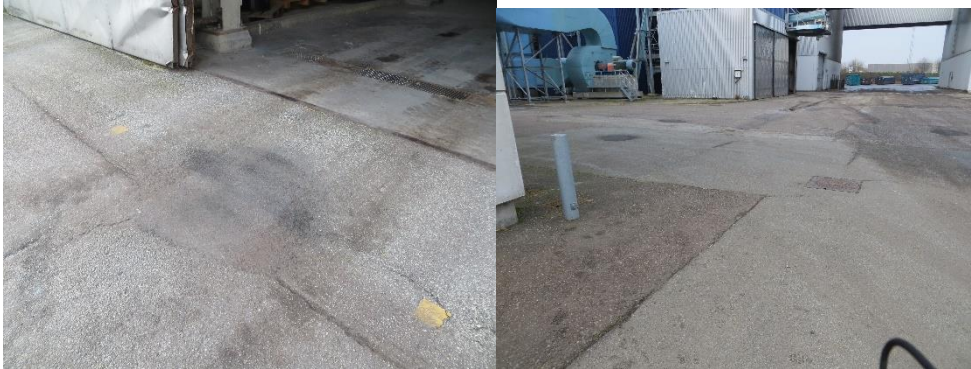
Udkørsel fra askeudmadningen (1) og udkørsel fra udmadningen af filterkager (2) Umiddelbar risiko for jordforurening.
