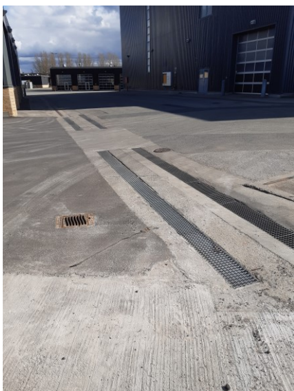
Nedløbsriste ved arealer til opbevaring af slaggecontainere
