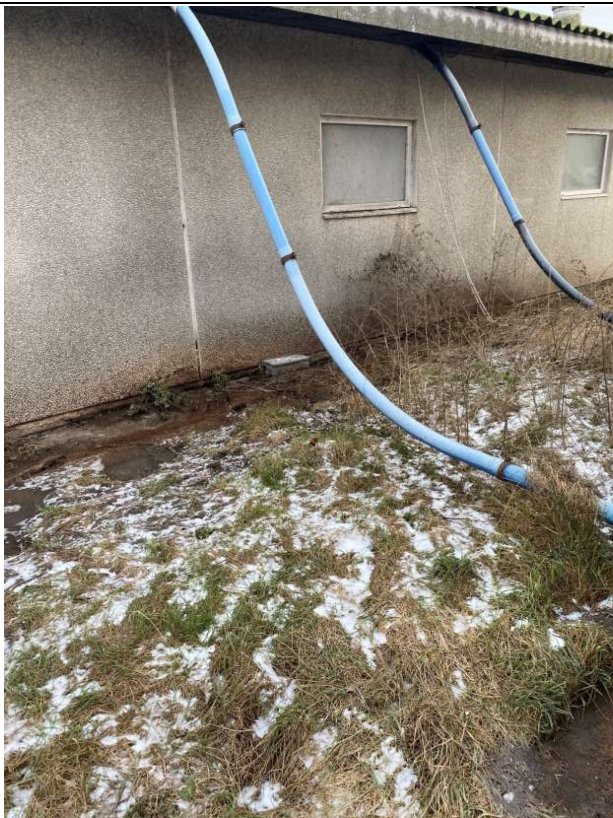
Foderspild under rør fra siloer til stalden.
