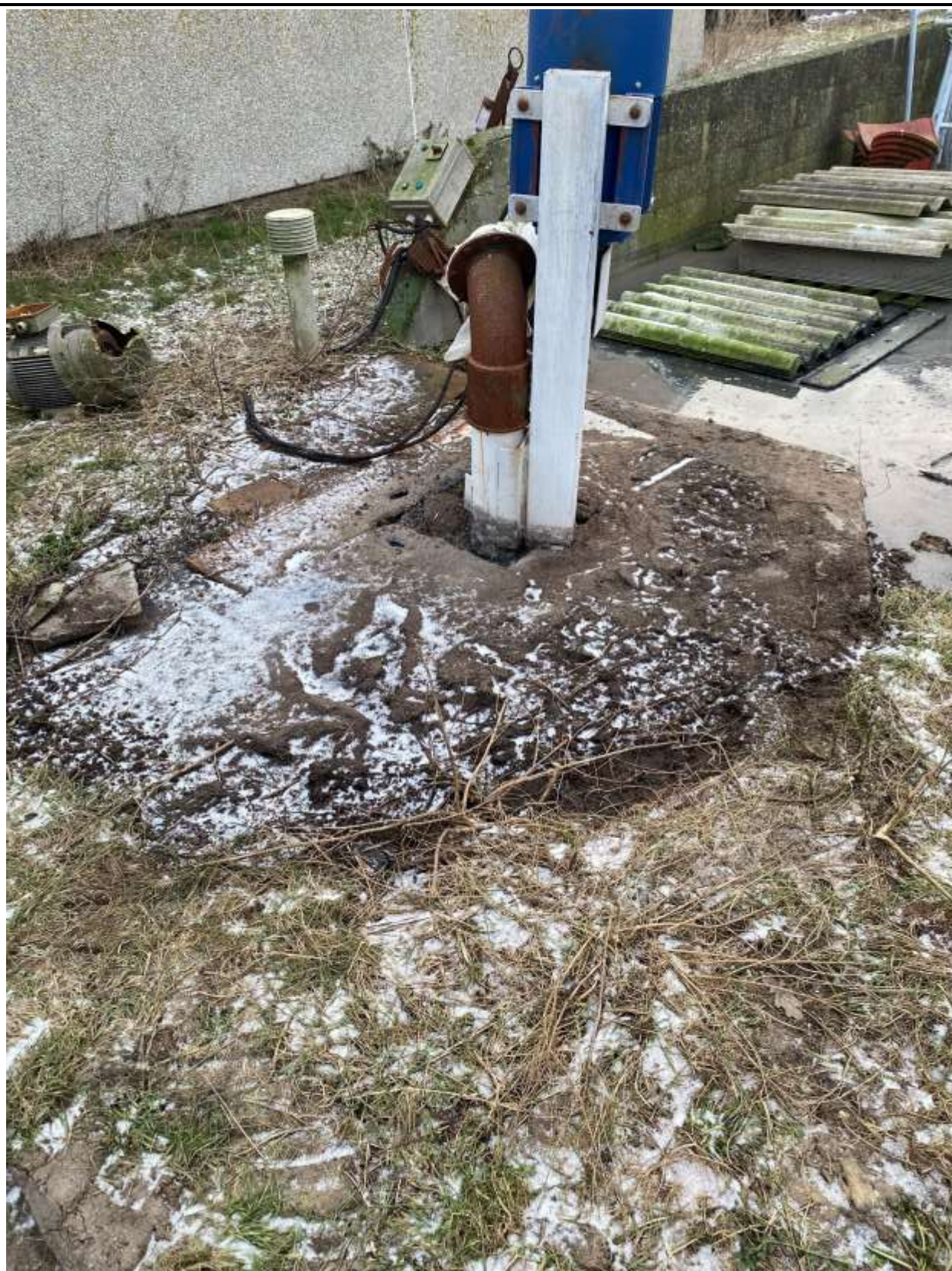
Overløb af gylle fra fortank.
