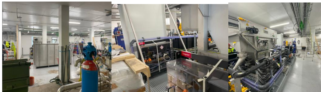
Billede 7: Billeder af for nyligt installeret renseanlæg.
