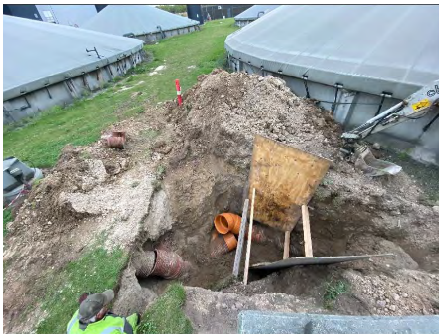
Figur 3. Manifold for lugtbekæmpelse 2 lokaliseret og opdelt i to systemer: Lugtbekæmpelse 2 og 4.
