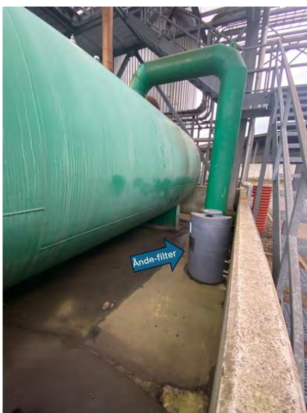
Figur 9. Lugtbekæmpelse SLOP: På SLOP-olietank er afkast blevet lukket og åndefilter etableret.
