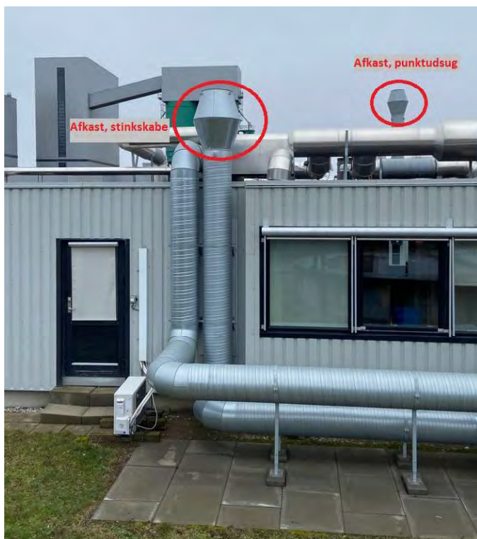
Figur 2. Afkast fra laboratorieudsugning. Der er 2 uafhængige sugemanifolder med hver deres afkast til det fri: "Stinkskabe" og "Punktudsugning".
