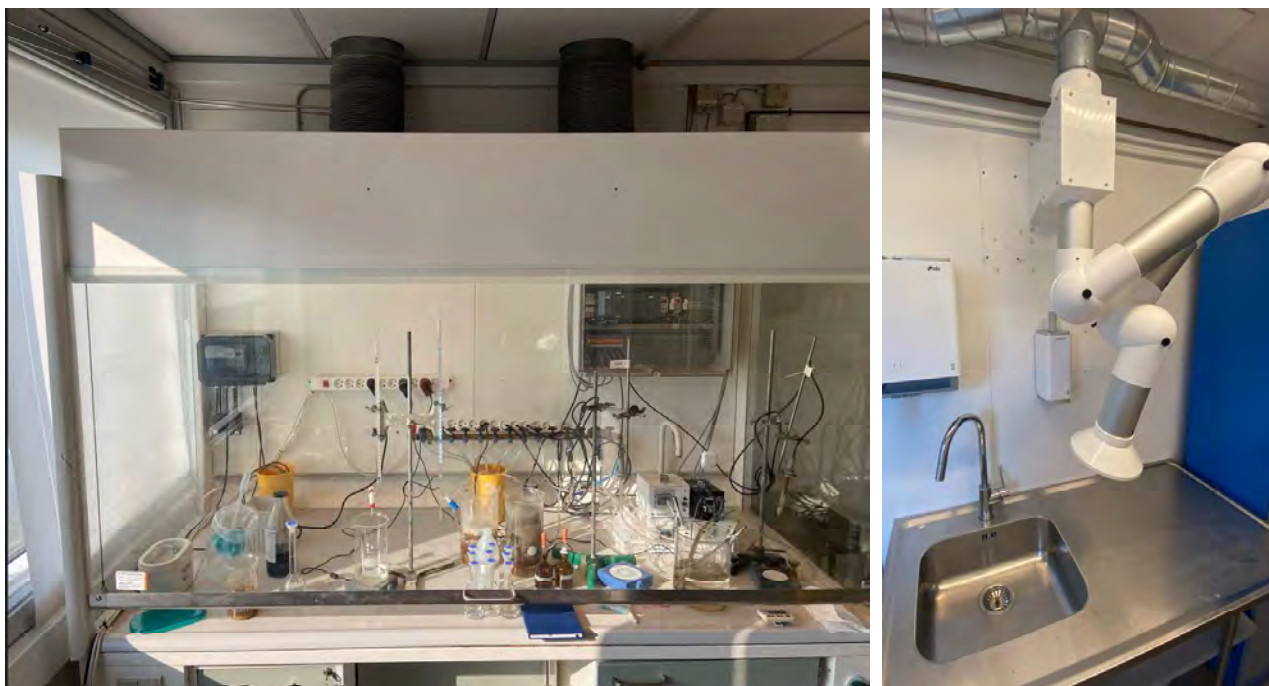
Figur 1. Arbejdsstationer hhv. i stinkskab (til venstre) og med punktudsug (til højre). Bemærk udsugningsrørene øverst i billedet, som er forbundet til udvendige afkast.
