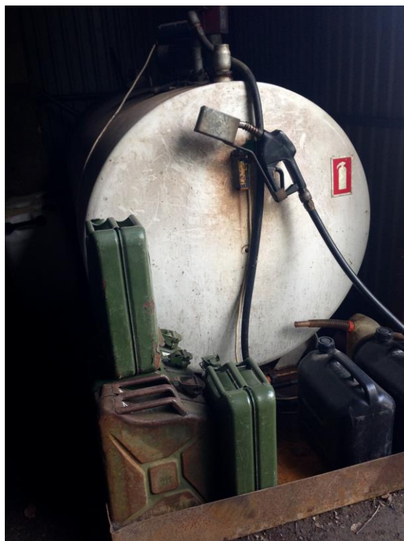
Dieseltank med spildbakke
