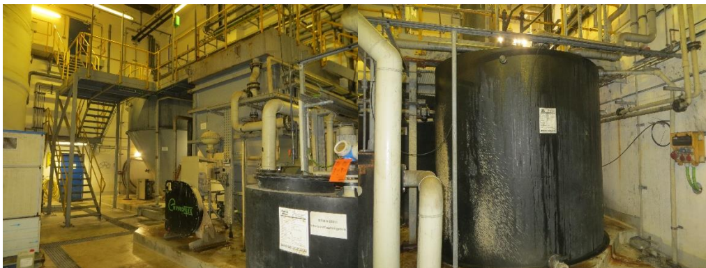
Dele af spildevandsreanseanlægget; spildevand fra røggasrensningensanlægget på anlægslinje 6.
