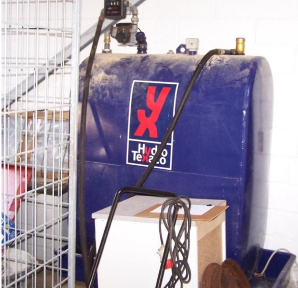
Fyringsolietank i anneks under halvtag mod nord – placeret på spildbakke
