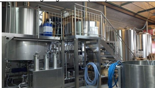
Brygværk samt en tank til varmt vand og en til koldt vand (2018)
