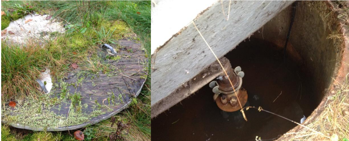
Figur 1. Boring 94.2710. Foto 1 er topdæksel og foto 2 viser brønd fyldt med vand.
