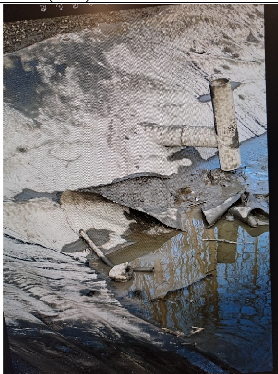
Tidligere hul i afdækkingsdug opdaget i forbindelse med rensning af laugen. Forholdet er udbedret (2024).
