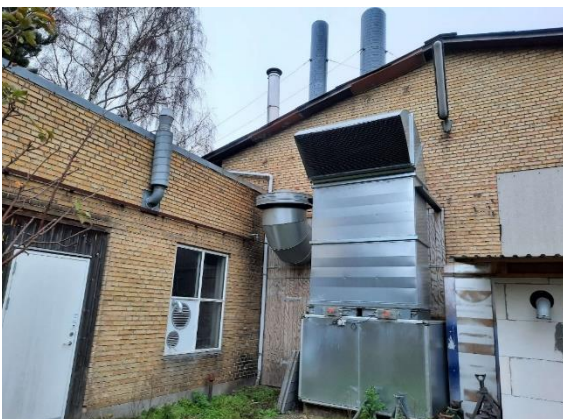
Støjsoleret ventilationsanlæg. Uændret siden sidste tilsyn. Der er ikke indkommet klager efterfølgende.
