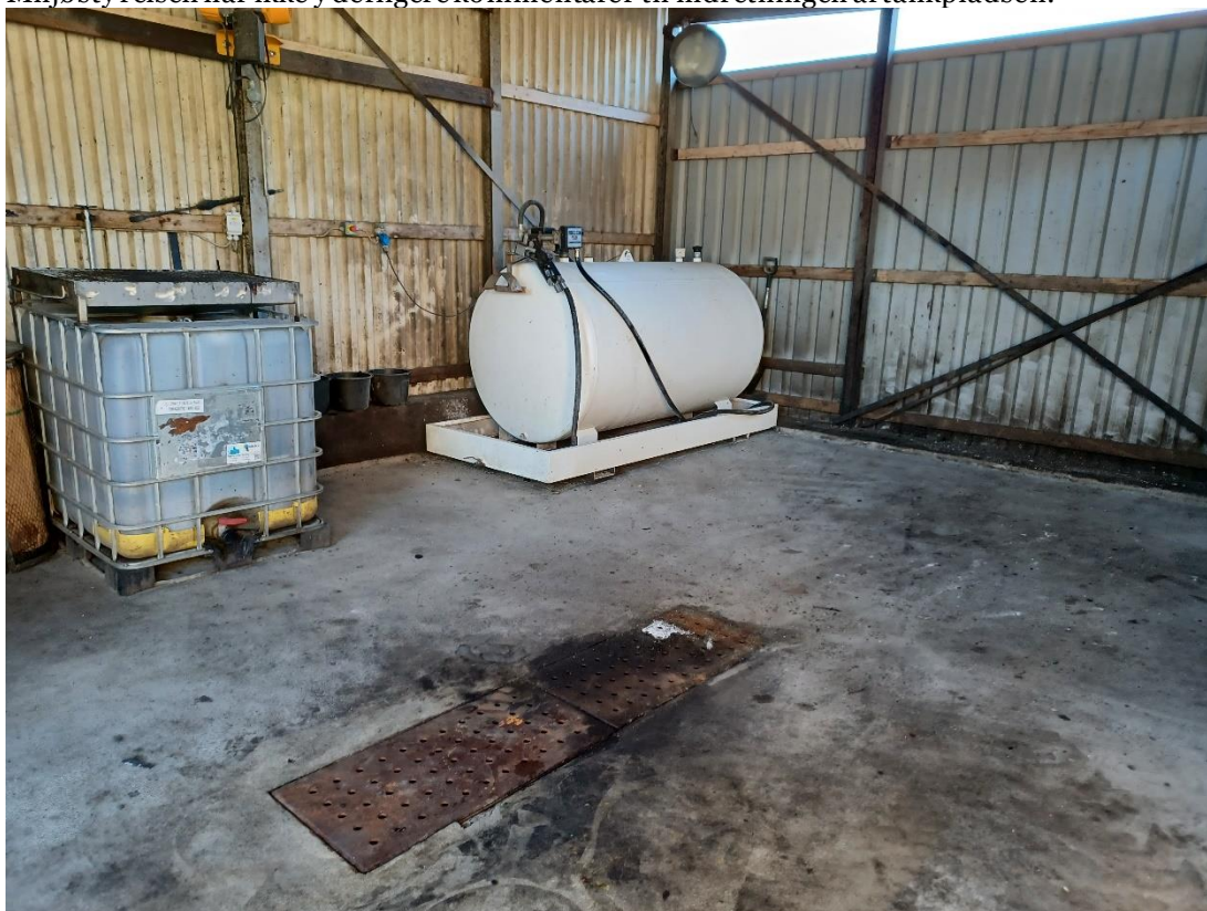
Billede 6 Tankplads under tag, på fast belægning med hældning mod afløb til olieudskiller.
