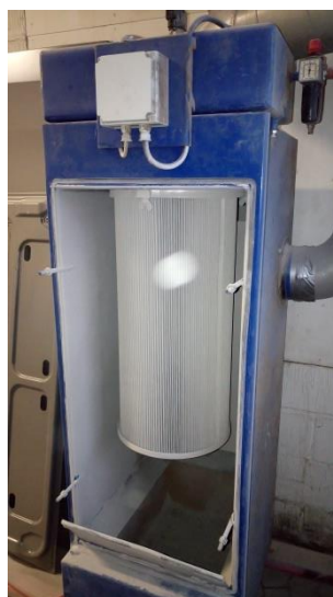
Billede nr. 4: Patronfilter i udsugningsanlægget for slibestøv.
