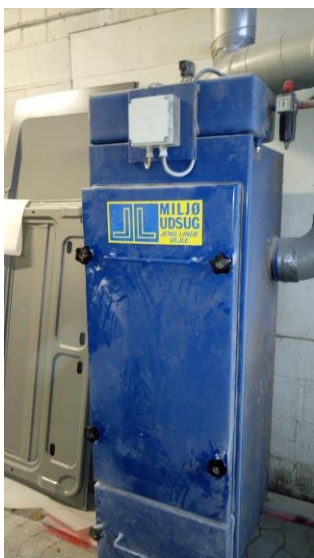
Billede nr. 3: Udsugningsanlæg for slibestøv
