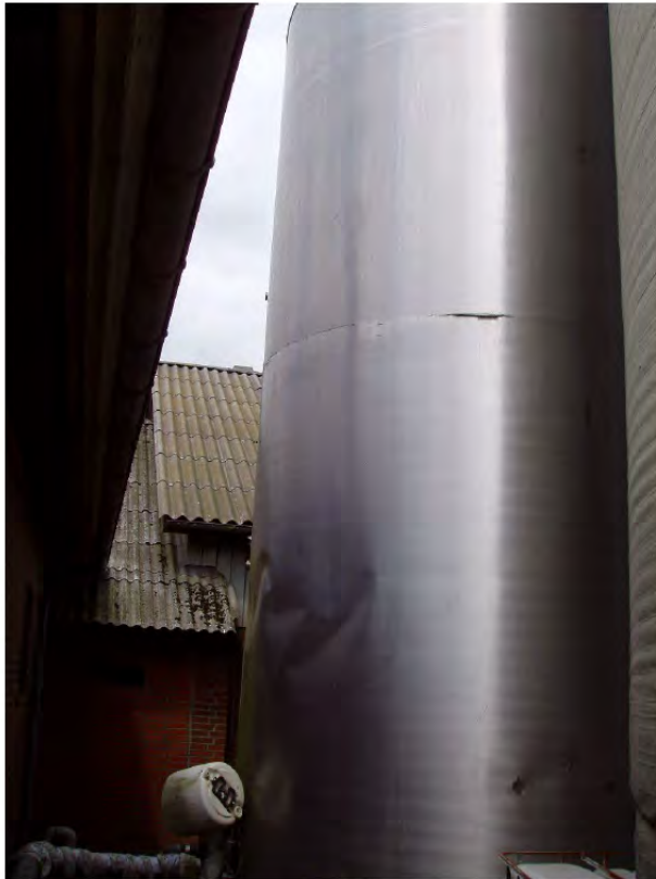
Ved bygning 3 foderlade er der placeret en 50 m3 ståltank til valle.
