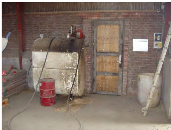
I bygning 3 foderlade står en 1200 liter dieselolie tank. Dieselolien bruges til en varmekanon
