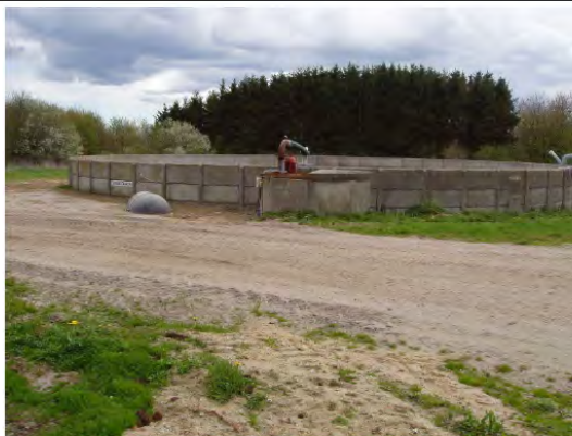
Gyllebeholder: Beton og gyllebeholder på 2000 m 3 Fortank: Fortank til gyllebeholdere er placeret i forgrunden
