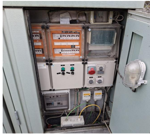
Foto 15. Strømskab til perkolatpumper
