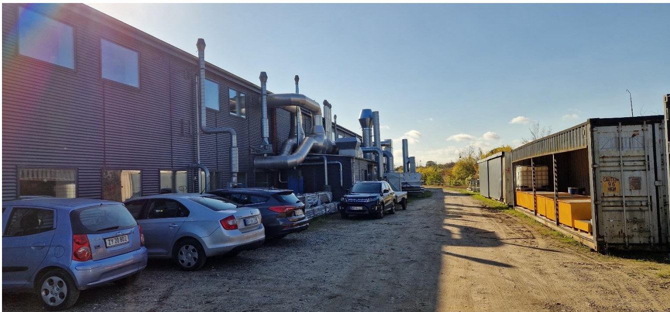
Udsugningsanlæg med filteranlæg for spåntagende bearbejdning.
