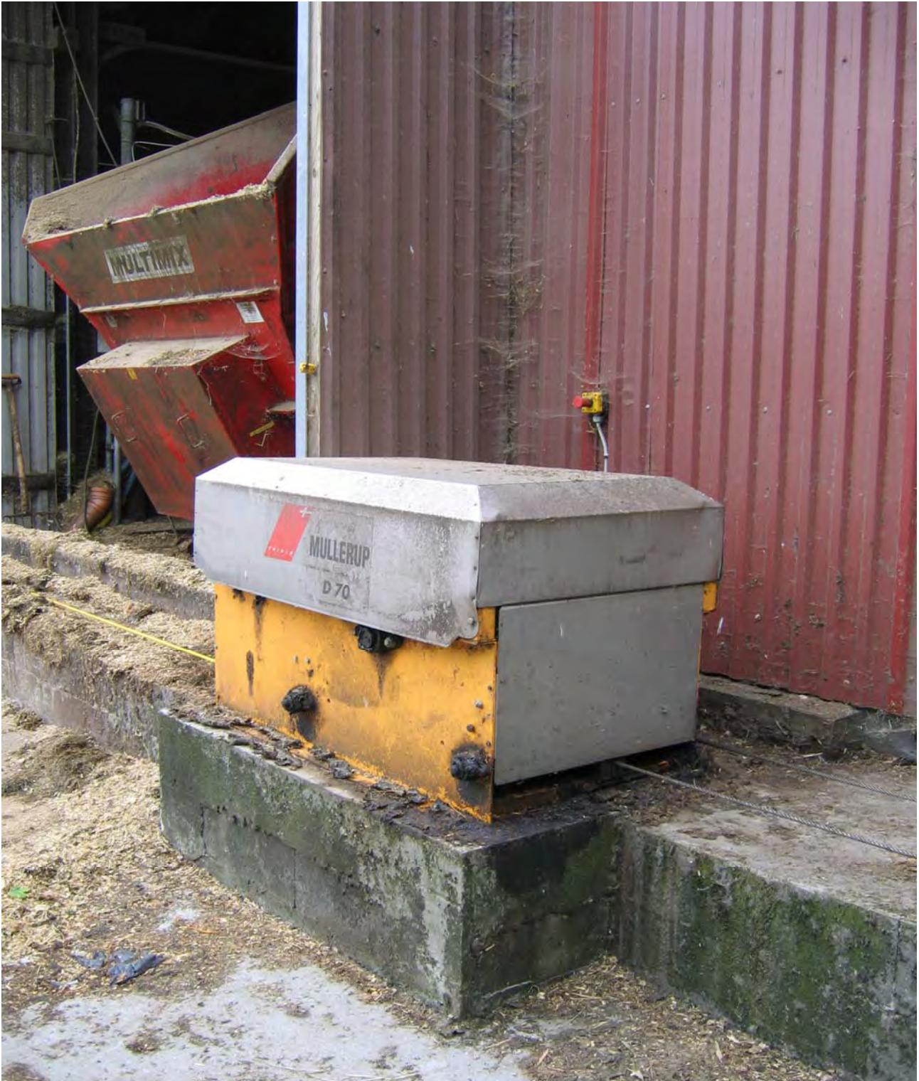
Billede 1. Trækstation med wiretræk placeret udendørs.
