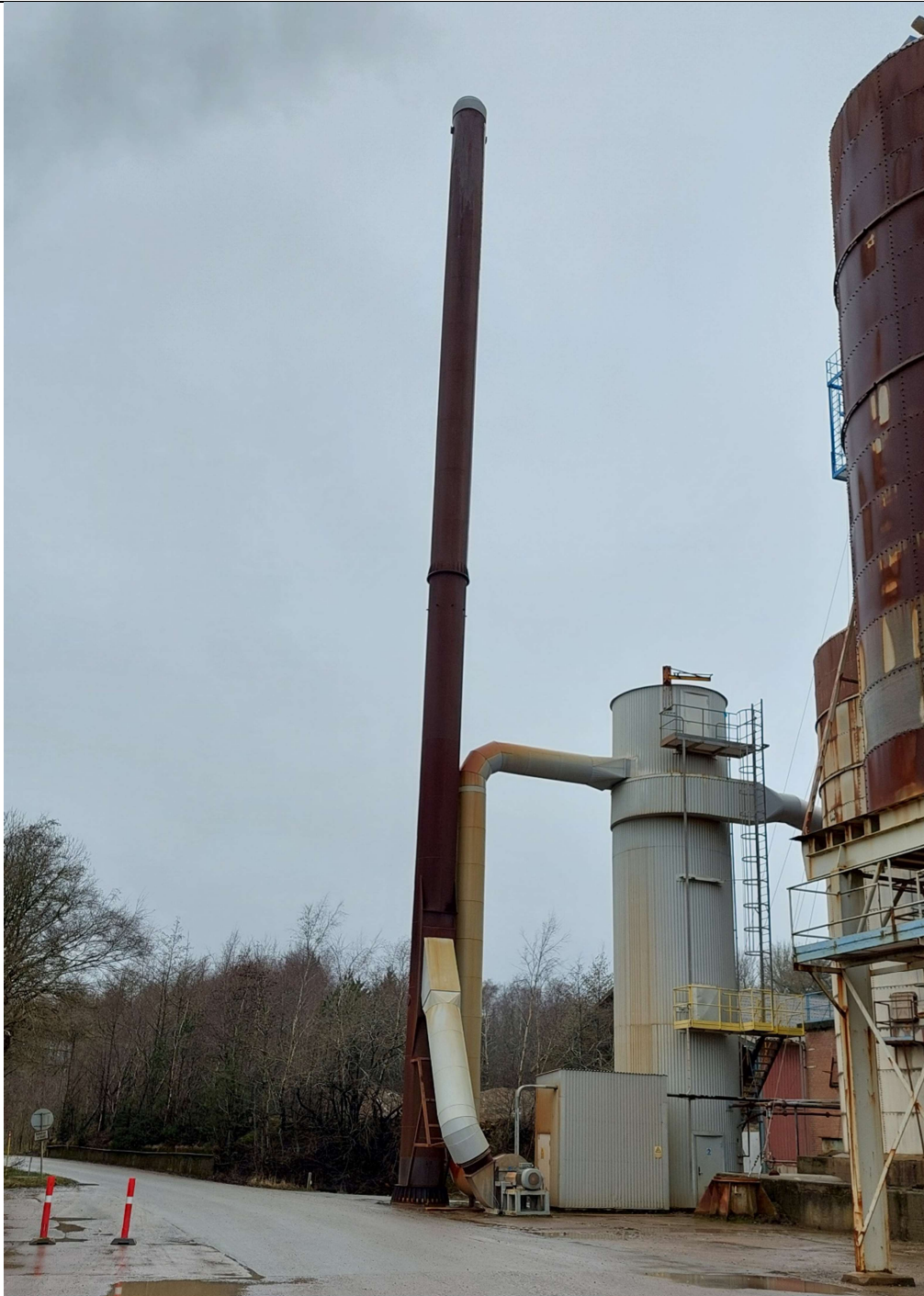
Billede 2. Skorsten. Øverst ses en metalring, hvor støjfiltret sidder på
