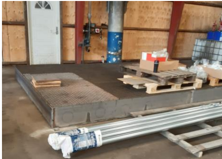
Ny plads til tømning af transformatorer
